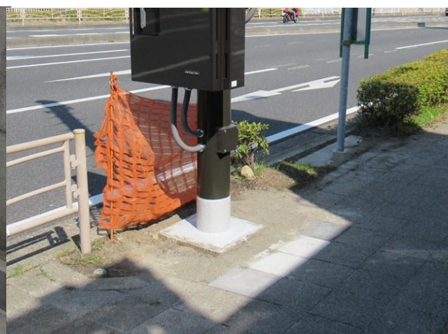
神奈川県 国道 防犯カメラ支柱
