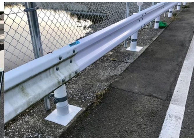
宮崎県 ガードレール支柱 2018年施工 沿岸部の錆び対策
