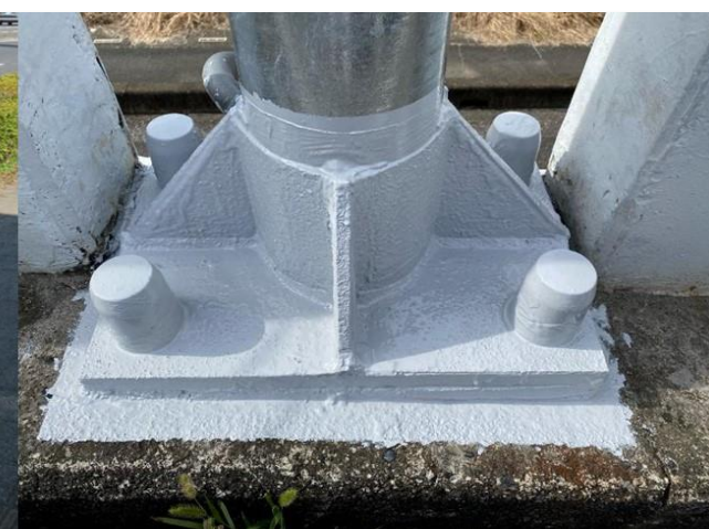
埼玉県 県道 道路照明柱
