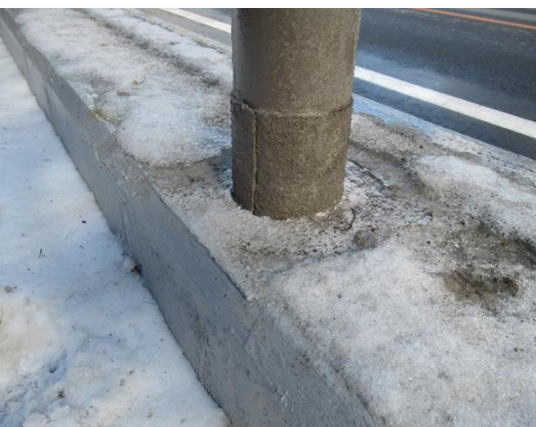
長野県 国道 転落防止柵
