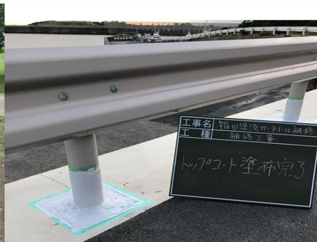
静岡県 漁港 ガードレール支柱 2019年施工 沿岸部の錆び対策
