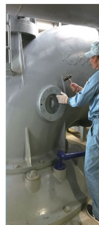
既存ポンプ設置点検窓
