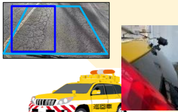
AIによる舗装損傷の自動検知
