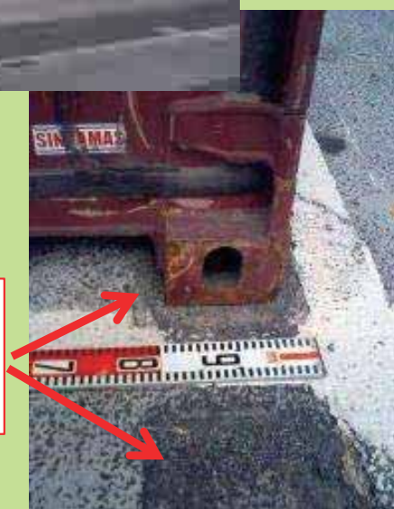
コンテナヤード
