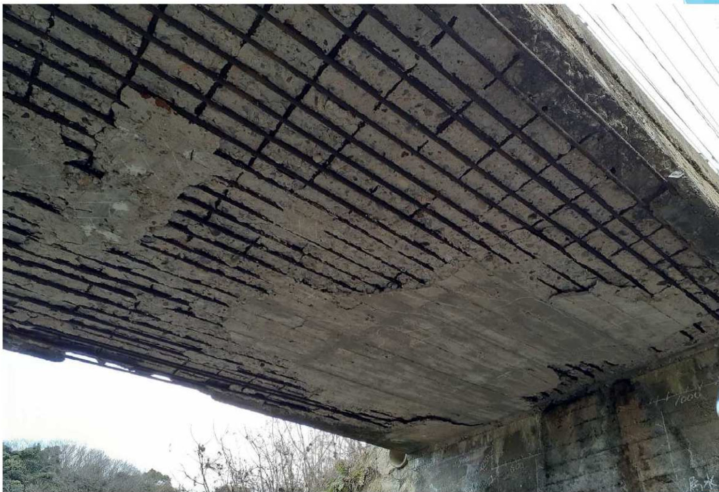
かぶり 剥落:湯谷橋(RC床版橋) 山口県 2023年1月
