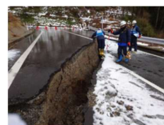
被災状況(道路)の調査
