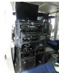
ヘリサットの通信設備(機上局)
