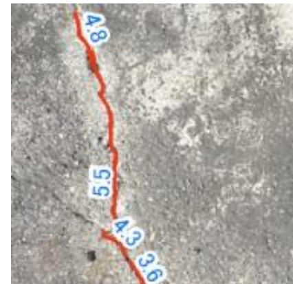
ひび割れの検出例
